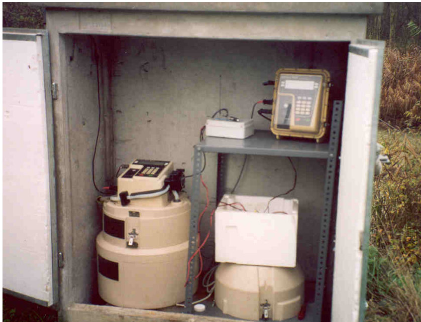
Fig. 1 Interno della cabina di una stazione di monitoraggio : il campionatore automatico di liquidi è a destra e l'idrometro a sinistra.
